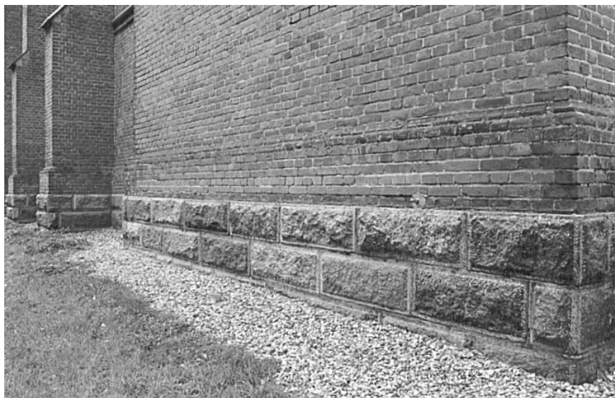
Rys. 2. Fragment kamiennego cokółu kościoła w Garbowie
