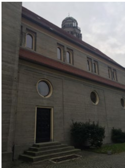
Ryc. 3. Fragment elewacji północnej z widocznymi śladami deskowań.
