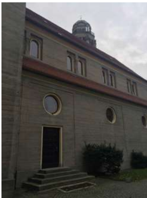
Ryc. 3. Fragment elewacji północnej z widocznymi śladami deskowań.
