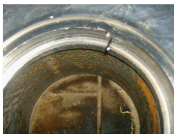
Rys. 3. Zużycie ścierno – korozyjne elementu pompy wysłokków [2]
