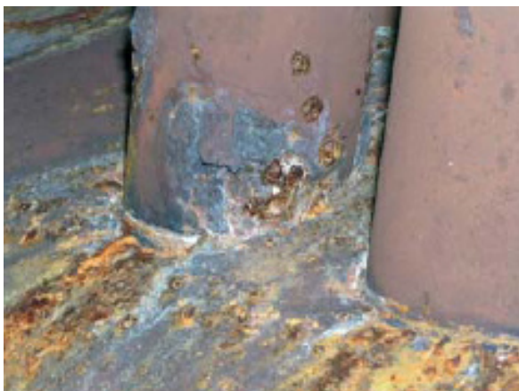
Rys. 2. Skorodowana ściana komory spalania i rur konwekcyjnych kotła
