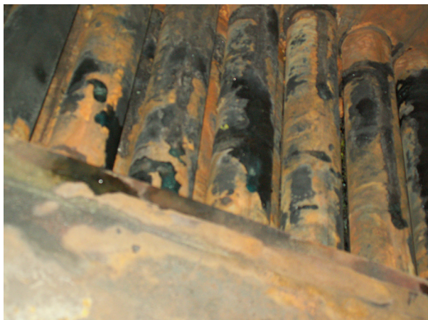
Rys. 5. Skorodowane rury ekranu kotła
