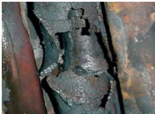
Rys. 6. Zniszczenie rury kotłowej w wyniku krótkotrwałego przegrzania
