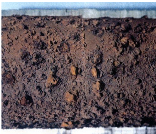
Rys.3. Korozja tlenowa rury kotłowej
