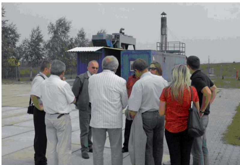
Obiekt ekoenergetyczny w postaci generatora zasilanego biogazem na terenie składowiska odpadów w Rokitnie
